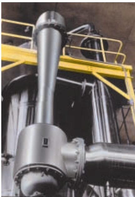
Cet évaporateur à flot tombant, à triple effet, produit jusque 5 680 hectolitres de lait condensé par heure. Un thermocompresseur entre le premier et le deuxième effets réduit la consommation de vapeur. Résultat, l'évaporateur consomme moins d'eau et nécessite une surface de transfert de chaleur moins grande.
